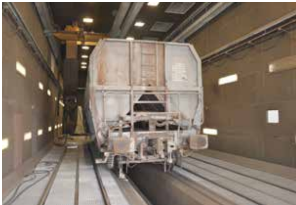
Robotlu Vagon Kumlama Tesis
